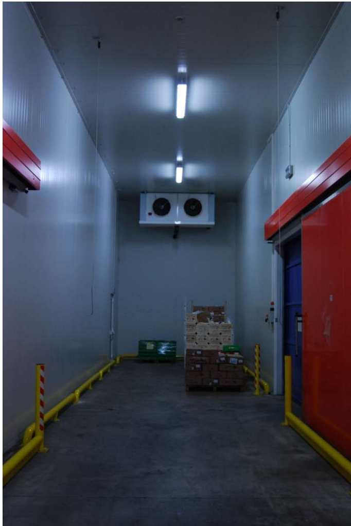
Ventilatori azionati da VSD
