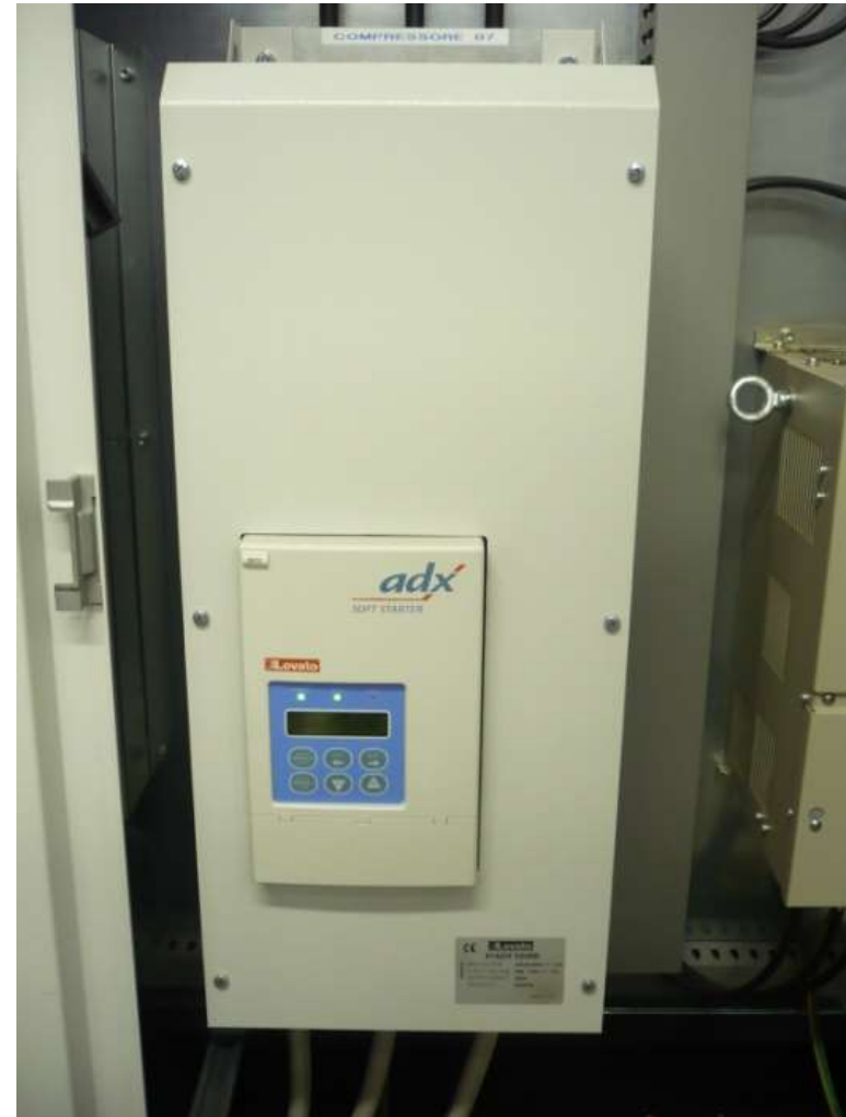
Inverter che modula la velocità del motore
